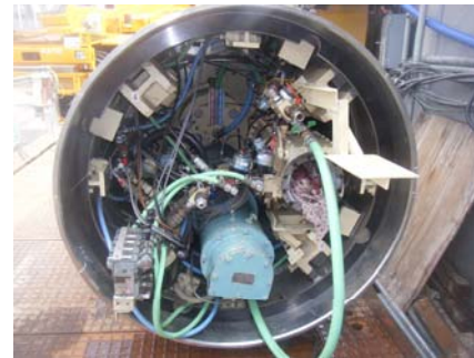
掘進機内状況
